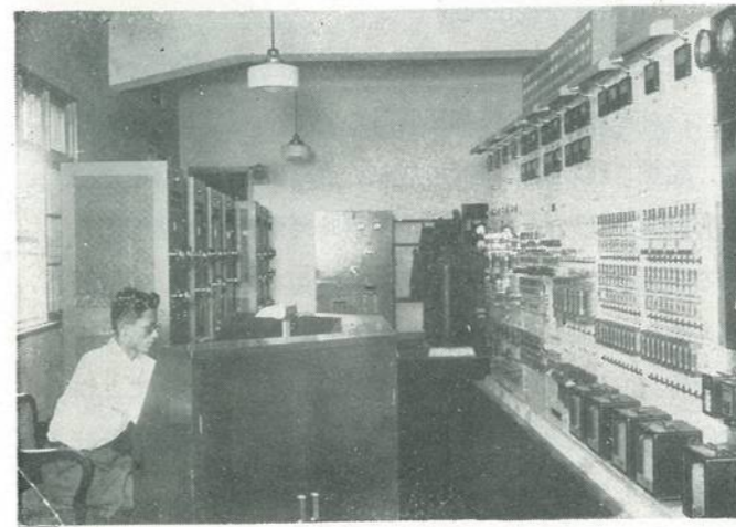
写真 22 標準器用電力室
