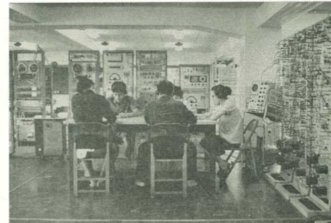
通信回線総合試験装置
