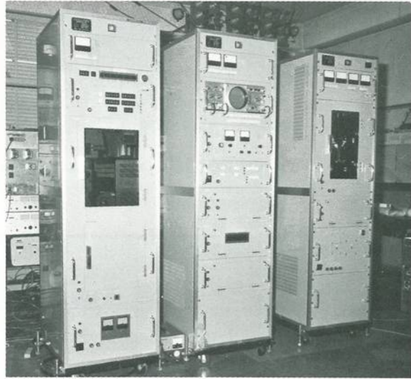
電離層観測装置
